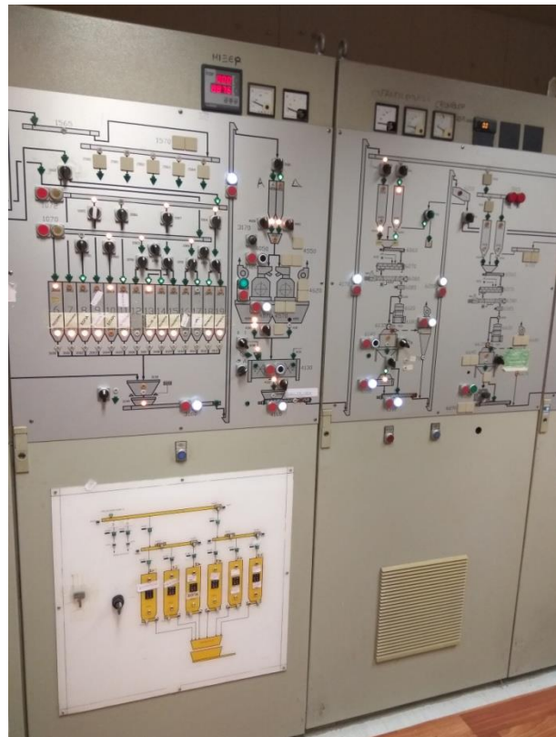
Εικόνα 15 (πάνω αριστερά) και εικόνα 16 (κάτω δεξιά): Ειδικός πίνακας ελέγχου γραμμής 1 και πρώτων υλών.
