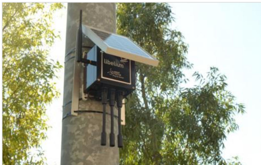
Εικόνα 3.3: Εγκατάσταση περιβαλλοντικού σταθμού.
