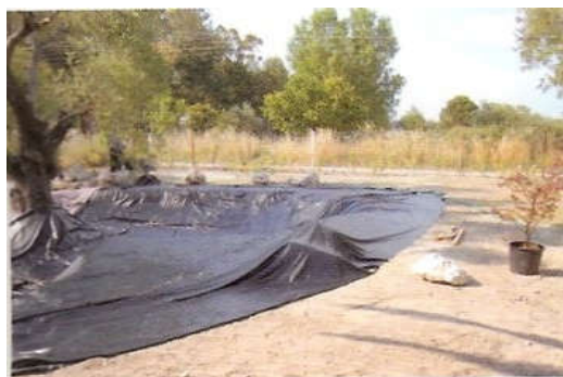
Εικόνα 71: Υδρόκηπος κατασκευασμένος με μεμβράνη PVC
