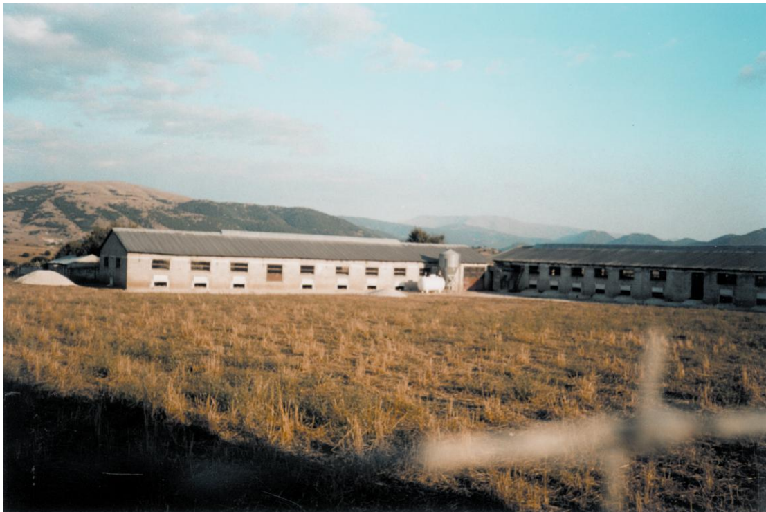
Εικ.38: Πτηνοτροφείο ελεύθερης βοσκής ύστερα από μετατροπή κτιρίων που χρησιμοποιούνταν για συμβατική εκτροφή κοτόπουλων. Διακρίνονται οι θύρες εξόδου των ορνίθων.
