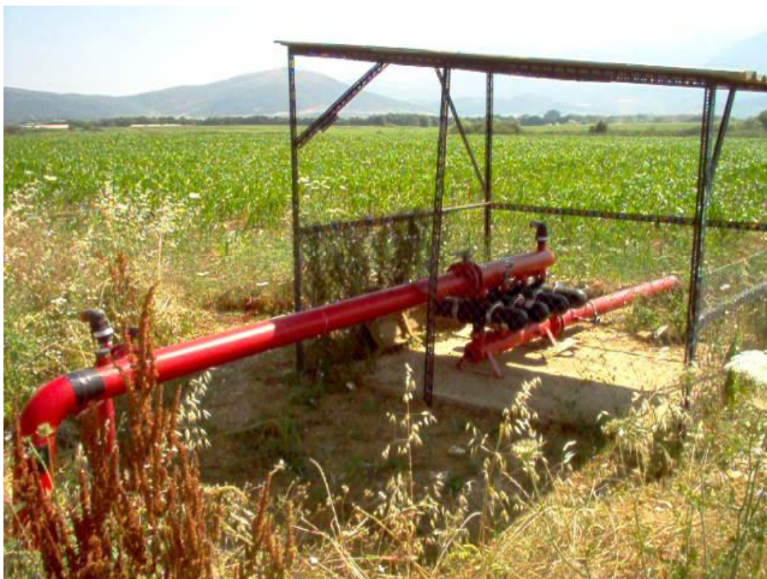
Εικ.12: Δευτερεύον φίλτρο νερού.
