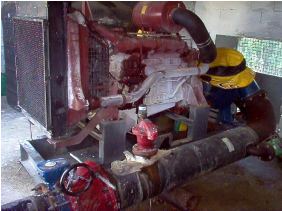
Εικ.10: Αντλία νερού.
