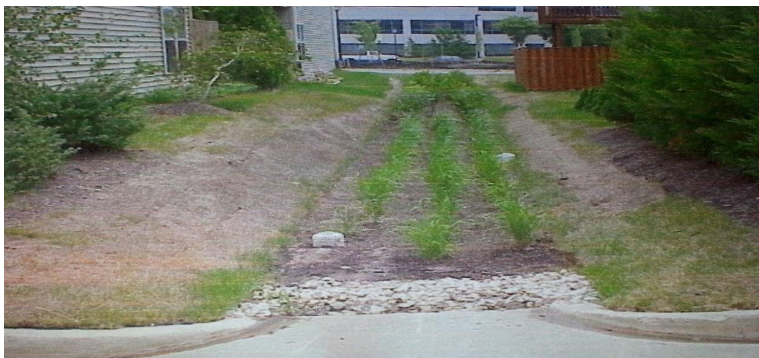
Εικ 41: Σύστημα βιοκατακράτησης σε μία πλήρως αστικοποιημένη περιοχή 66
