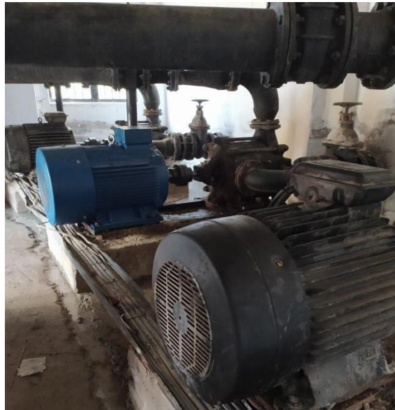
Εικόνα 6: Αντλίες στο αντλιοστάσιο του ΤΟΕΒ
