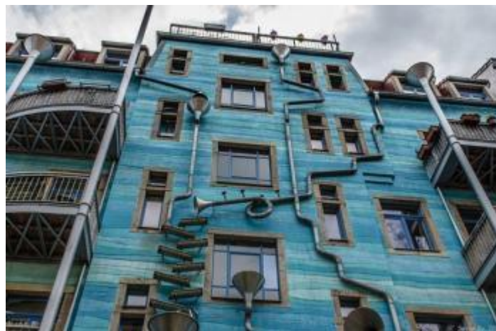
Εικόνα 5.8: Κατακόρυφη εγκατάσταση σε τοίχο κτιρίου (Πηγή: https://www.tilestwra.com/8-ichitika-glipta-pou-pezoun-mousiki-me-ti-dinami-tis-fisis/ )
