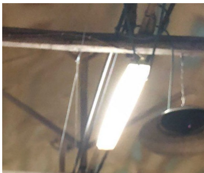
ΕΙΚΟΝΑ 27. Τεχνητός φωτισμός πτηνοτροφικής μονάδας
