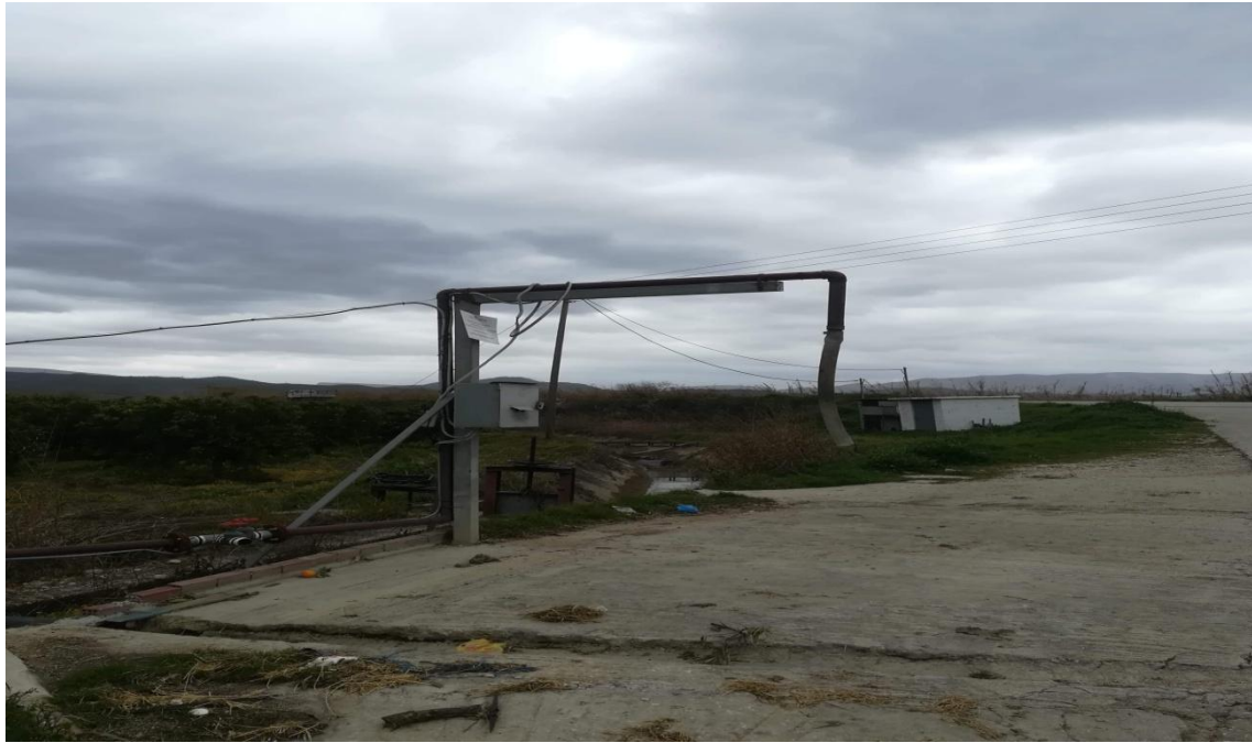
Εικόνα 26 Σύστημα τροφοδοσίας ψεκαστικών μνηαχημάτων με νερό, περιοχή Ασπροκκλησίου
