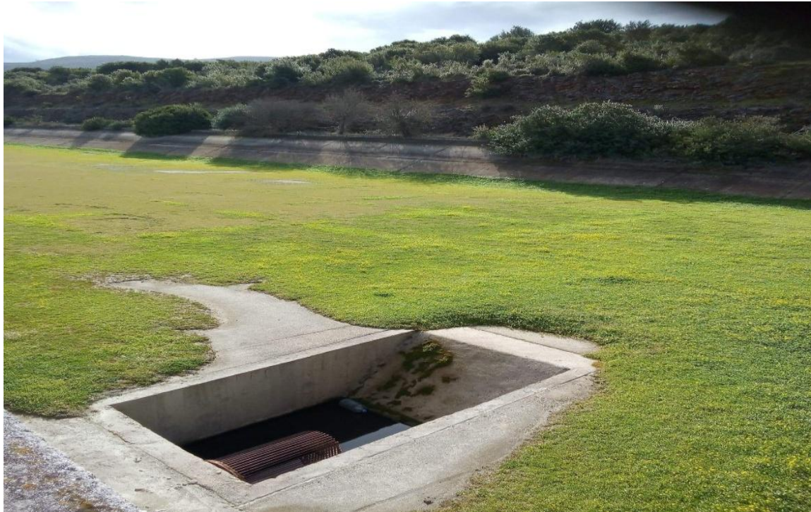
Εικόνα 5 Φρέατιο τροφοδοσίας νερού Φαναρίου, ΟΕΒ Αχέροντα
