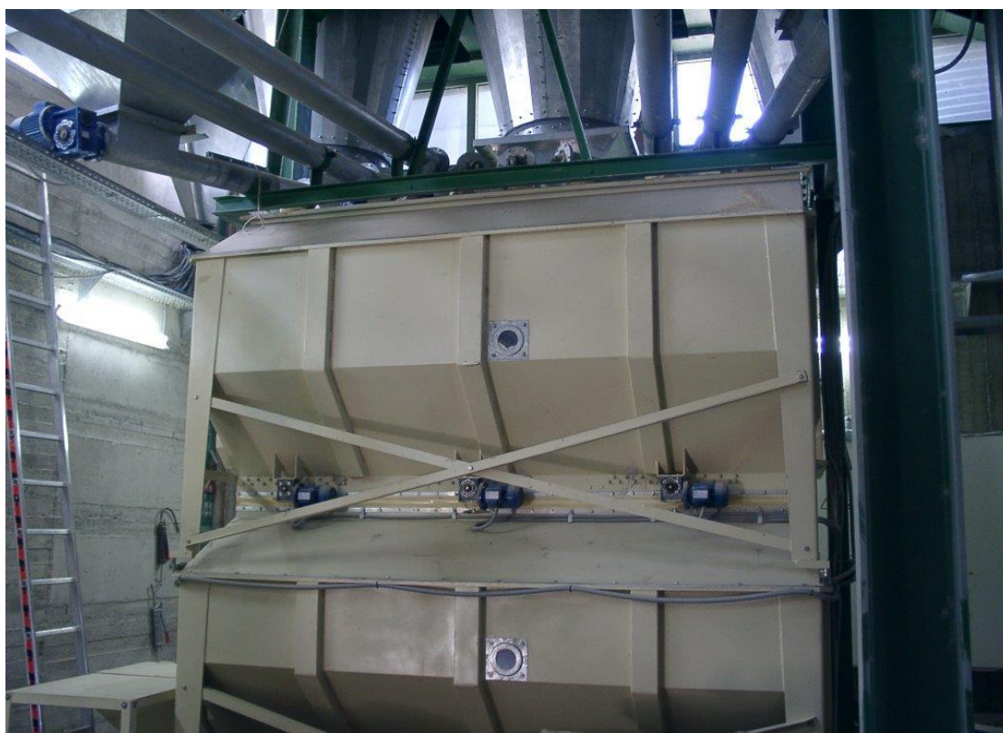
Εικόνα 25: Η ζυγαριά (στο πάνω μέρος της κατασκευής) και ο χώρος αναμονής (στο κάτω μέρος της κατασκευής), από πάνω τους διακρίνουμε τα σιλό εργασίας.
