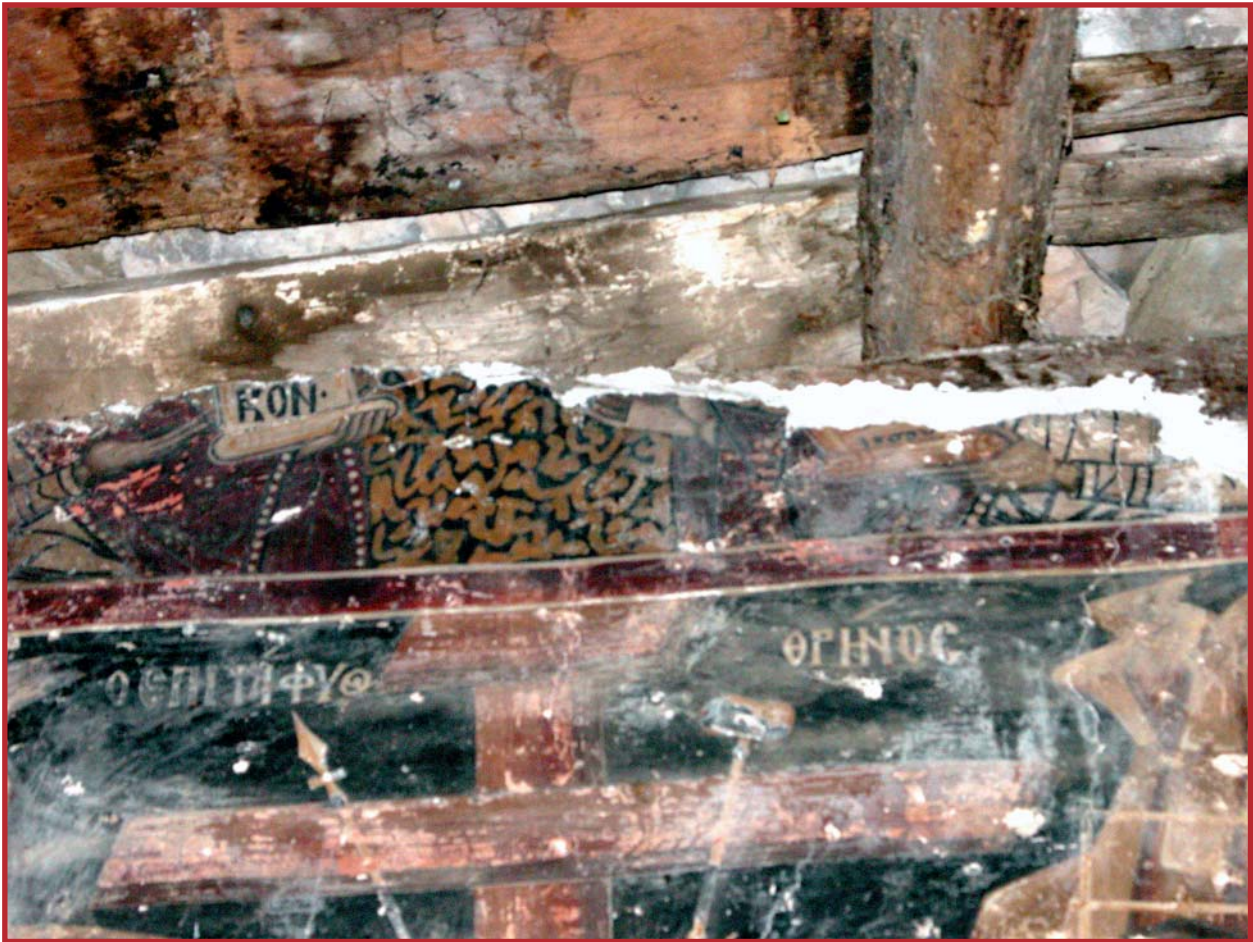
74. Ι.Ν. Αγ. Δημητρίου Σάββου. Βόρειος τοίχος, κατεστραμμένοι ημικύλινδρος με προφήτες (πάνω)
