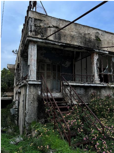
Εικόνα 7: Λεπτομέρεια κτιρίου με έντονα σημάδια δομικής διάβρωσης και οξείδωσης του μεταλλικού εξοπλισμού. Η ανεξέλεγκτη βλάστηση στο πρώτο πλάνο υπογραμμίζει την απουσία ανθρώπινης δραστηριότητας και τη μετατροπή του χώρου σε «αρχιτεκτονική του κενού». (Φωτ. Ν. Ηρακλέους, 2025)
