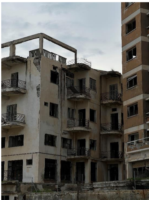
Εικόνα 9: Λεπτομέρεια διάβρωσης σε πολυώροφο κτίριο του παραλιακού μετώπου. Η οξείδωση του οπλισμού και η αποσάθρωση του σκυροδέματος μετατρέπουν το κτίριο σε ένα «επιβαρυνόμενο σώμα», όπου η υλική φθορά οπτικοποιεί την παύση του χρόνου. (Φωτ. Ν. Ηρακλέους, 2025)
