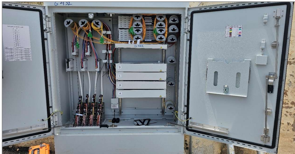
Εικόνα 9: Εσωτερικό Καμπίνας FTTH
