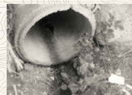
φωτογραφία αγωγού ομβρίων σε ρέμα
