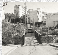
Ιδιωτική, η οποία φαίνεται να επηρεάζει την απόρροση ροή του ρέματος εξαιτίας της διαμόρφωσης της, καθώς έχουν κατασκευαστεί τοίχοι βαρύτητας προκαλώντας στένεμα στην κοίτη.
