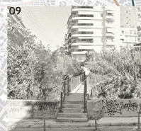
Παρατηρείται έντονη διάβρωση κάτω της πεζογέφυρας Κορυψή
