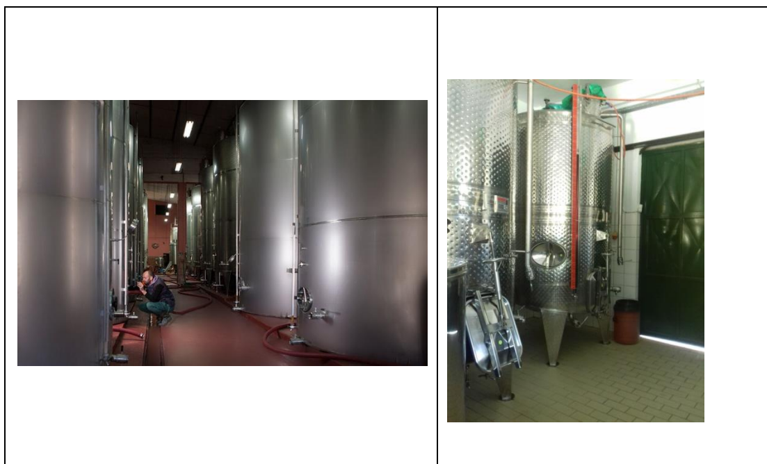
Εικόνα 29: αριστερά: ανοξείδωτες δεξαμενές απλές, πηγή: gastronomytours.gr, ZOINOS WINERY, δεξιά: ανοξείδωτες δεξαμενές διπλού τοιχώματος, jacket, με δυνατότητα ψύξης, πηγή: προσωπικό φωτογραφικό αρχείο από Οινοποιείο Παπαθανασίου
