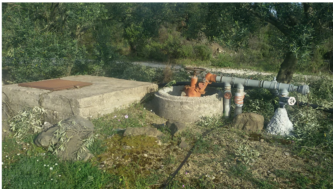
Εικόνα 8 Υδροληψία συλλογικού δικτύου σε καλλιέργεια ελιάς στην Άρτα (πηγή: Εργαστήριο Γ. Μηχανικής & Διαχ. Φυσικών Πόρων Τμ. Τεχνολόγων Γεωπόνων ΤΕΙ Ηπείρου)
