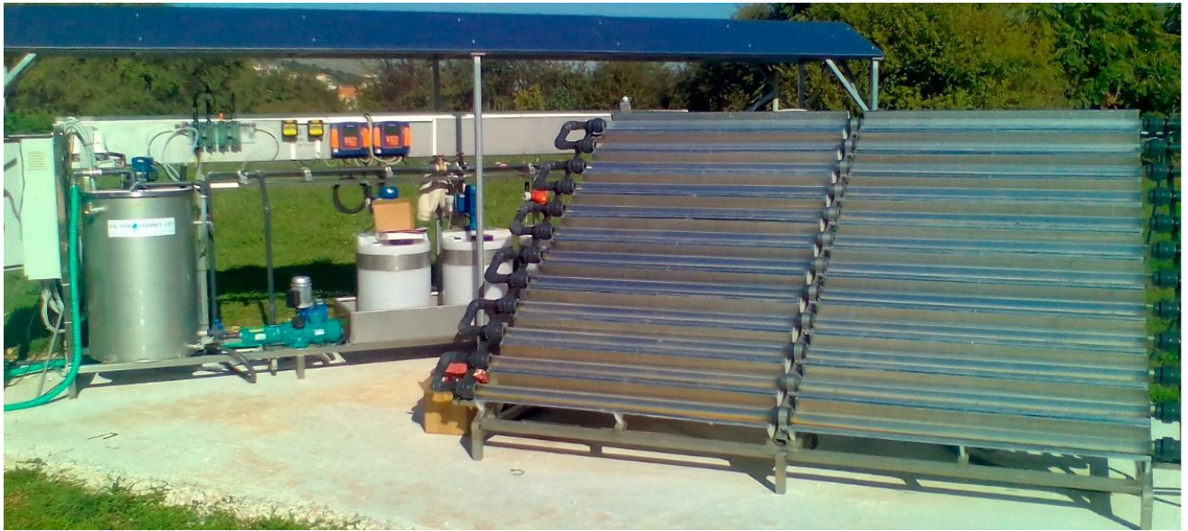
Εικόνα 6.3: Φωτογραφία του CPC φωτοκαταλυτικού πιλοτικού αντιδραστήρα εγκατεστημένου στην Μ.Ε.Υ.Α. στον χώρο του Πανεπιστημιακού Νοσοκομείου Ιωαννίνων.
