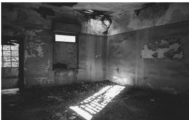
Εικόνα (55) : Εσωτερικός χώρος ΑΗΣ φαλήρου
