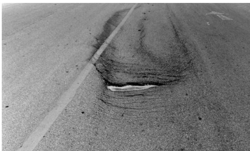
Εικόνα 7: Ρωγμές από ολίσθηση ταπήτων ( www.asphaltinstitute.org )
