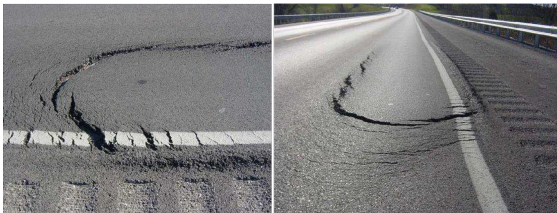
Εικόνα 8: Σπάσιμο ασφάλτου οδοστρωσίας εξαιτίας κακής συγκόλλησης των ασφαλτικών στρωμάτων λόγω υπερβολικής επάλειψης γαλακτώματος (Woods, 2003, Al-Qadi et al. 2012b)
