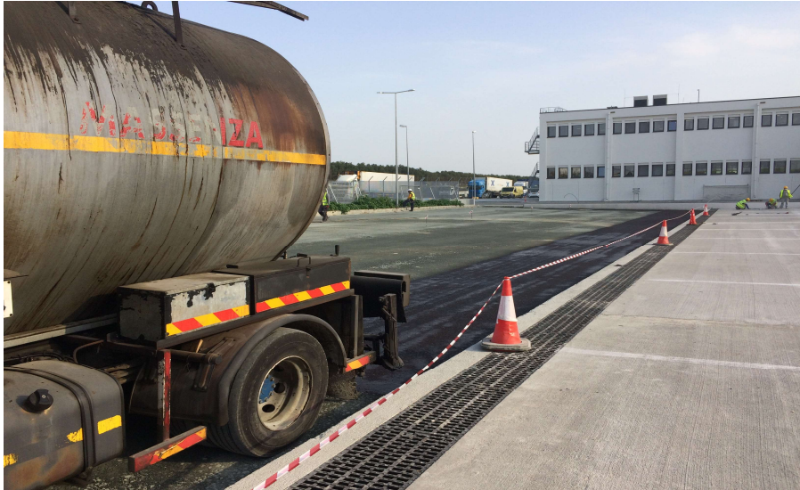
Εικόνα 5: Διανομέας (federal)ασφαλτικού διαλύματος
