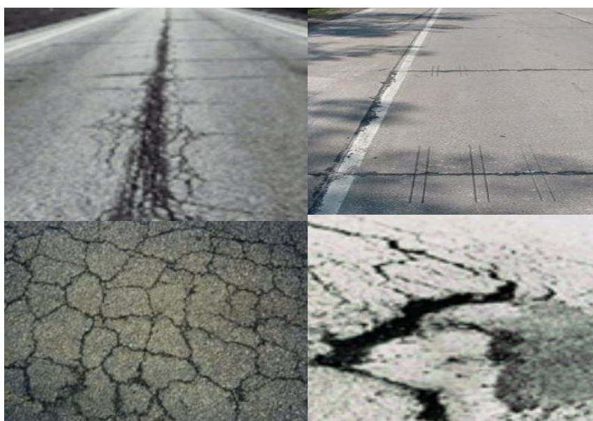
Σχήμα 11: Παραδείγματα ρηγματώσεων εύκαμπτων οδοστρωμάτων
