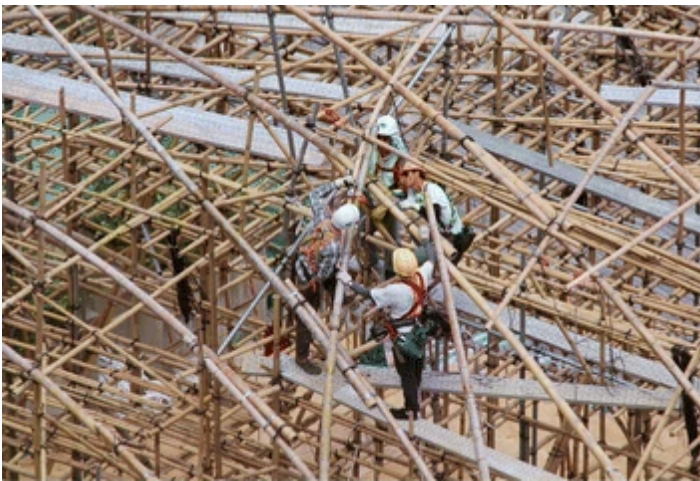
Εικ.22: Επιτόπια εγκατάσταση με αντιστοίχιση των αντίστοιχων ετικετών
