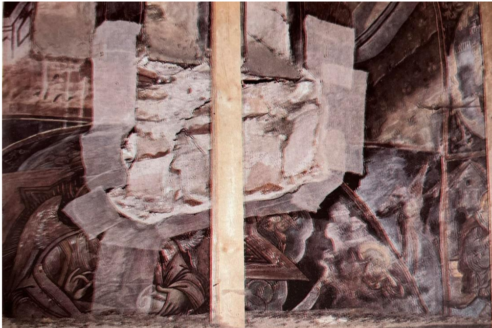
Εικόνα 140: Μ. Προδρόμου, λεπτομέρεια νότιου αφιδώματος, όπου διακρίνεται η απόσταση τοιχογραφιών και μεγάλου τμήματος τοιχοποιίας
