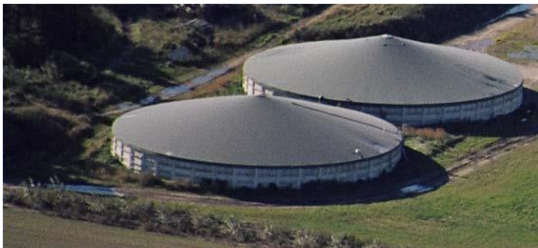
Εικόνα 18: Δεξαμενή αποθήκευσης καλυμμένη με μεμβράνες (Danish Biogas Association, 2008).
