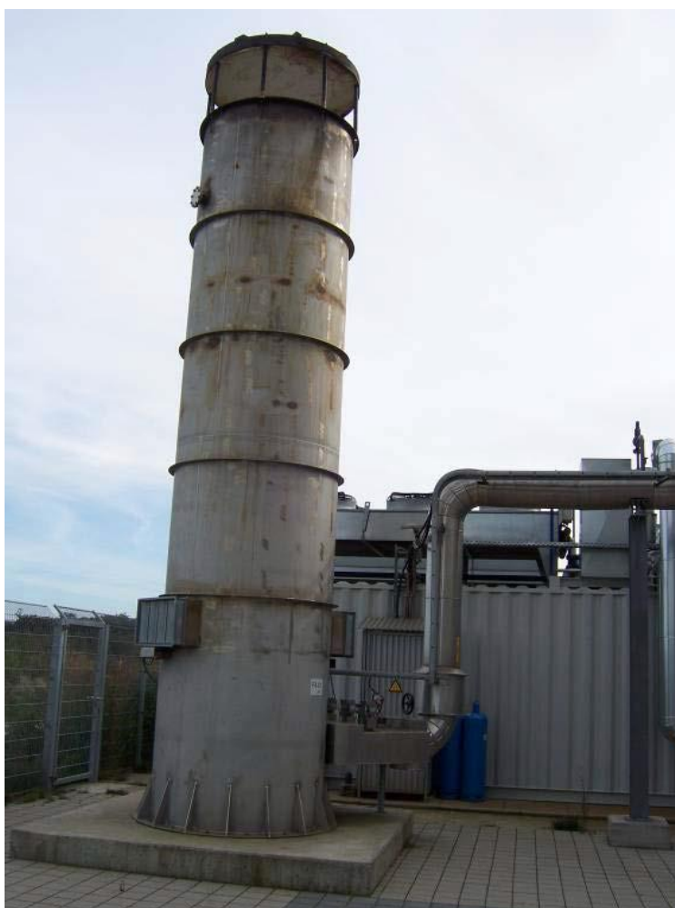
Εικόνα 23: Πυρσός καύσης βιοαερίου (Γιακουμέλος, Λ- ΚΑΠΕ 2012).
