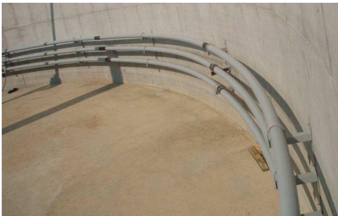
Εικόνα 15: Σωληνώσεις θέρμανσης με καυτό ατμό στο εσωτερικό του αντιδραστήρα-χωνευτή (Γιακουμέλος-ΚΑΠΕ 2012).
