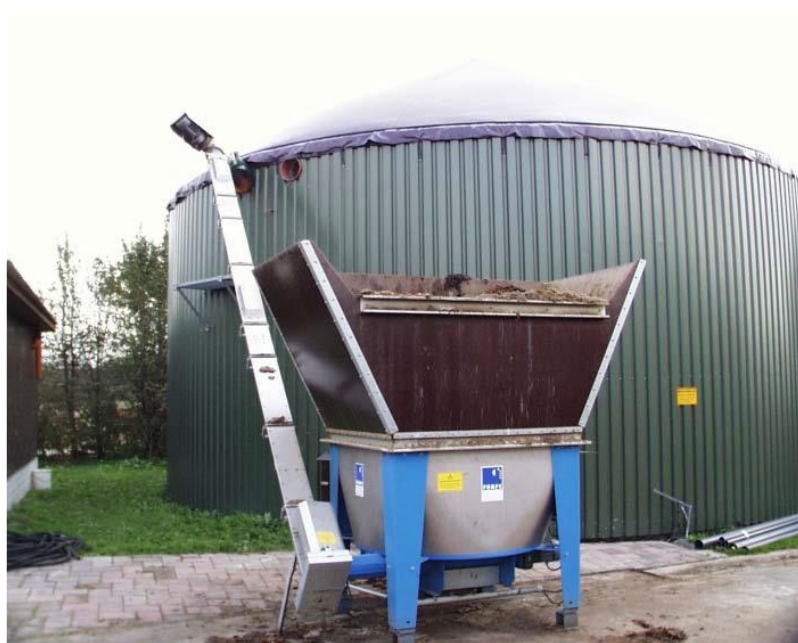
Εικόνα 14: Κοχλίας μεταφοράς στερεών υλικών απευθείας στον χωνευτή (Γιακουμέλος-ΚΑΠΕ 2012).
