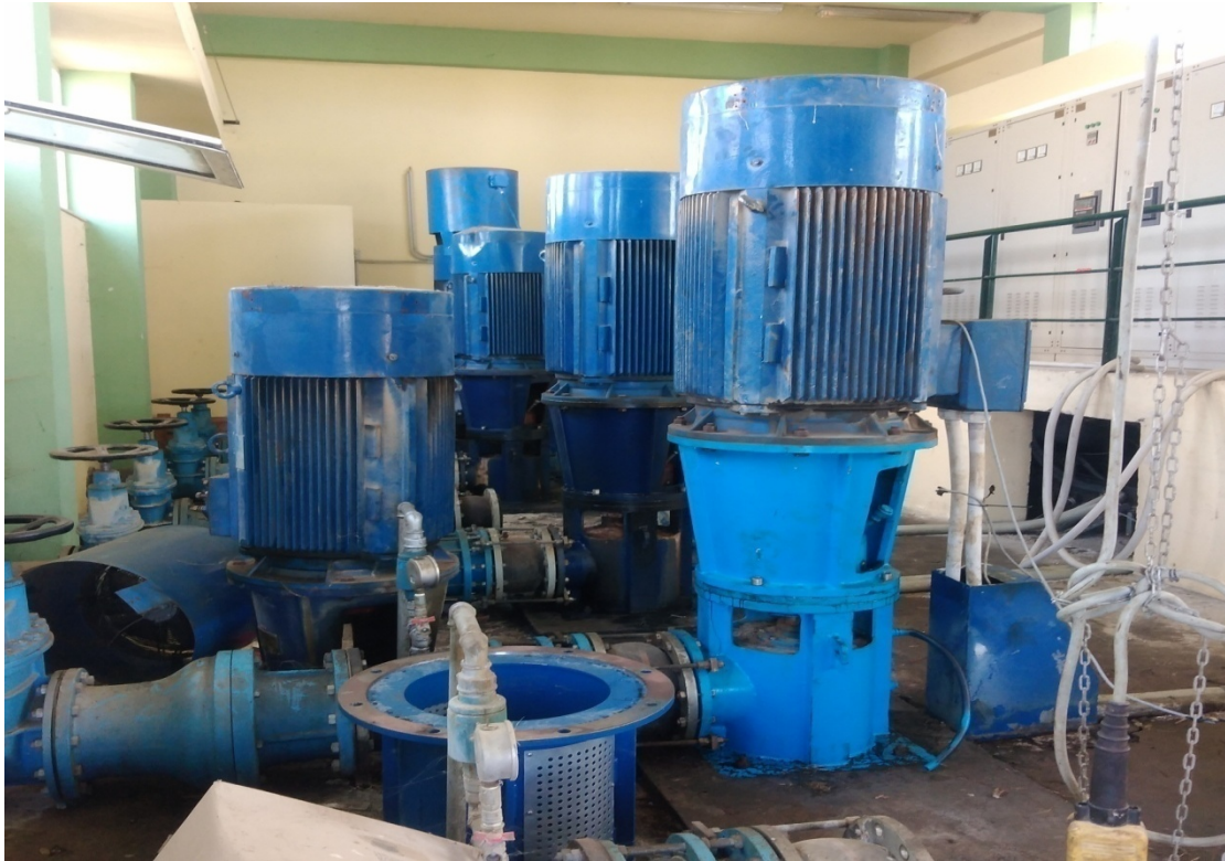
Εικόνα 9. Εσωτερικός χώρος Αντλιοστασίου Βαλανιδοράχης
