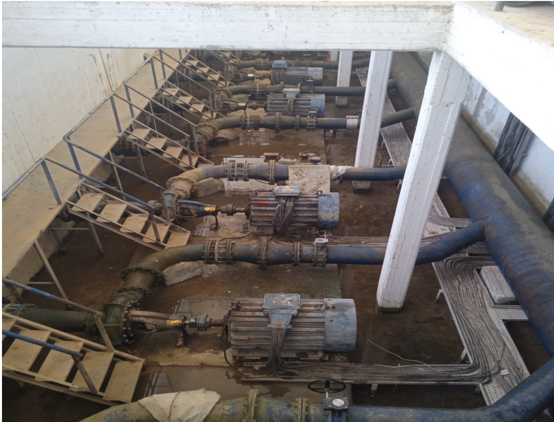
Εικόνα 7. Εσωτερικός χώρος Αντλιοστασίου Θέμελου
