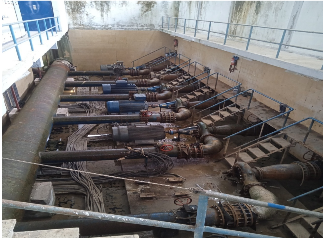
Εικόνα 5. Εσωτερικός χώρος αντλιοστασίου Γλυκής
