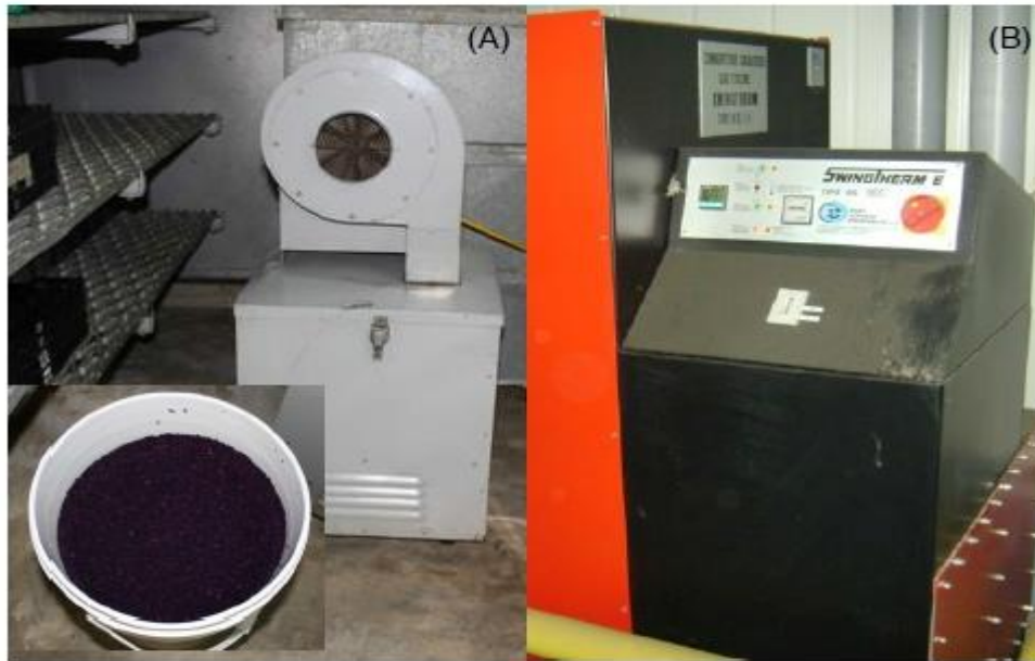
Εικόνα 18. (A) Σύστημα οξείδωσης του αιθυλενίου με διάταξη φίλτρου που περιέχει υπερμαγγανικό κάλιο ( \text{KMnO}_4 , Purafil). (B) Σύστημα καταλυτικής οξείδωσης του αιθυλενίου Swintherm.
