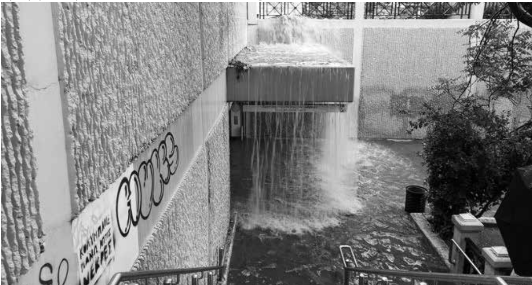
Εικόνα 16: Φωτογραφικό υλικό από την πλημμύρα Daniel στην Αττική, Σταθμός Ευαγγελισμού Πηγή εικόνας: «Κακοκαιρία Daniel: Κλειστός ο σταθμός Μετρό «Ευαγγελισμός» - Πλημμύρισε από την σφοδρή καταιγίδα», THETOC, 06/09/2023, thetoc.gr
