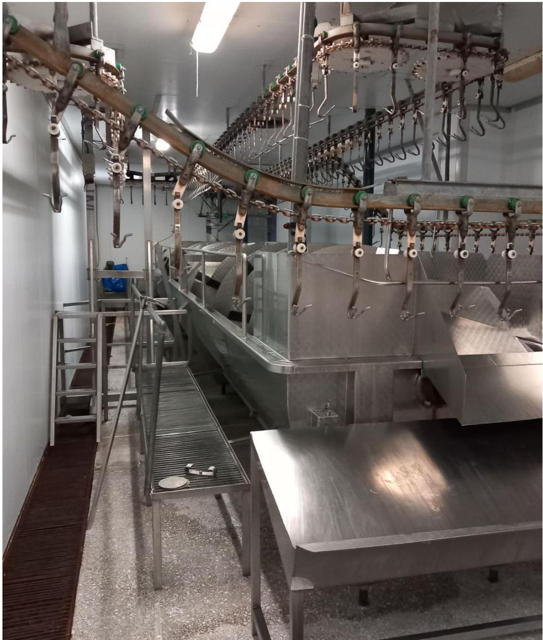
Εικόνα Β3. 13 Πτην/γείο Β- Chiller
