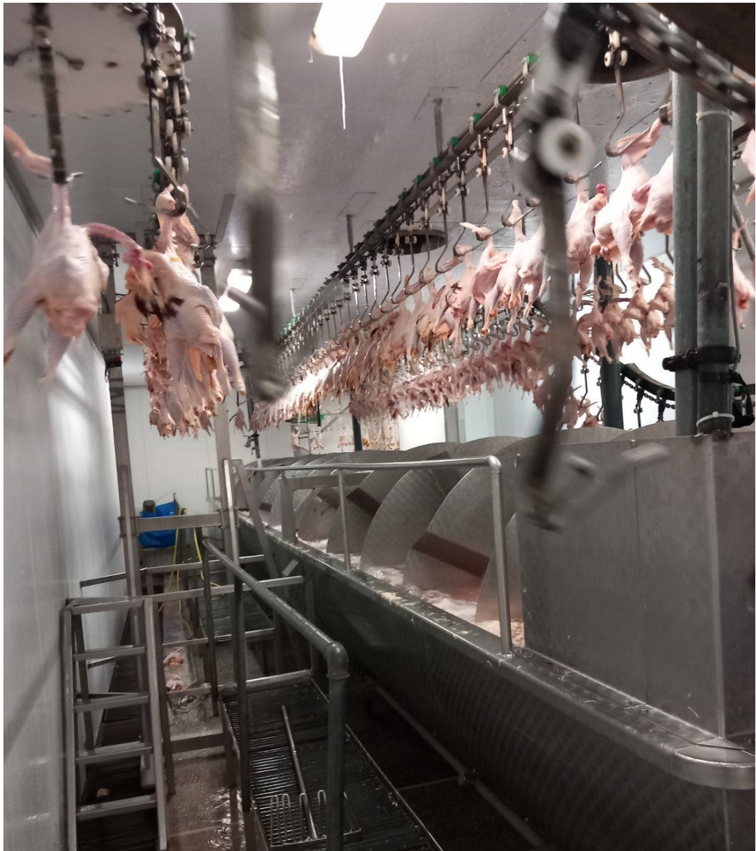
Εικόνα Β3. 7 Πτηνοσφαγείο Β-Υδρόψυξη-Chiller
