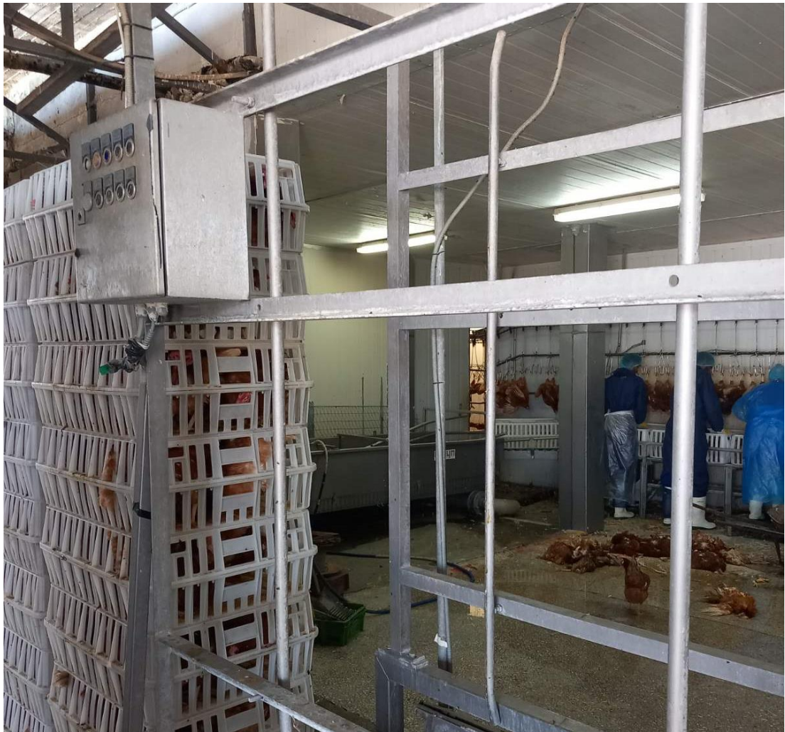
Εικόνα Β3. 5 Πτηνοσφαγείο Β-Αγκίστρωση πτηνών
