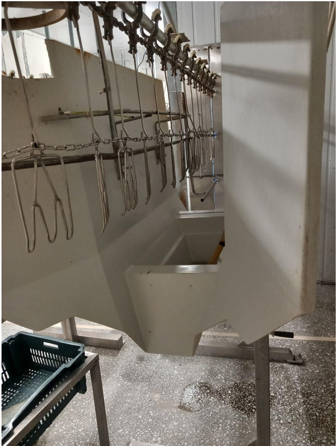
Εικόνα Β3. 10 Πτην. Β-Λεκάνη αναισθητοποίησης -Ηλεκτρικό υδρόλουτρο
