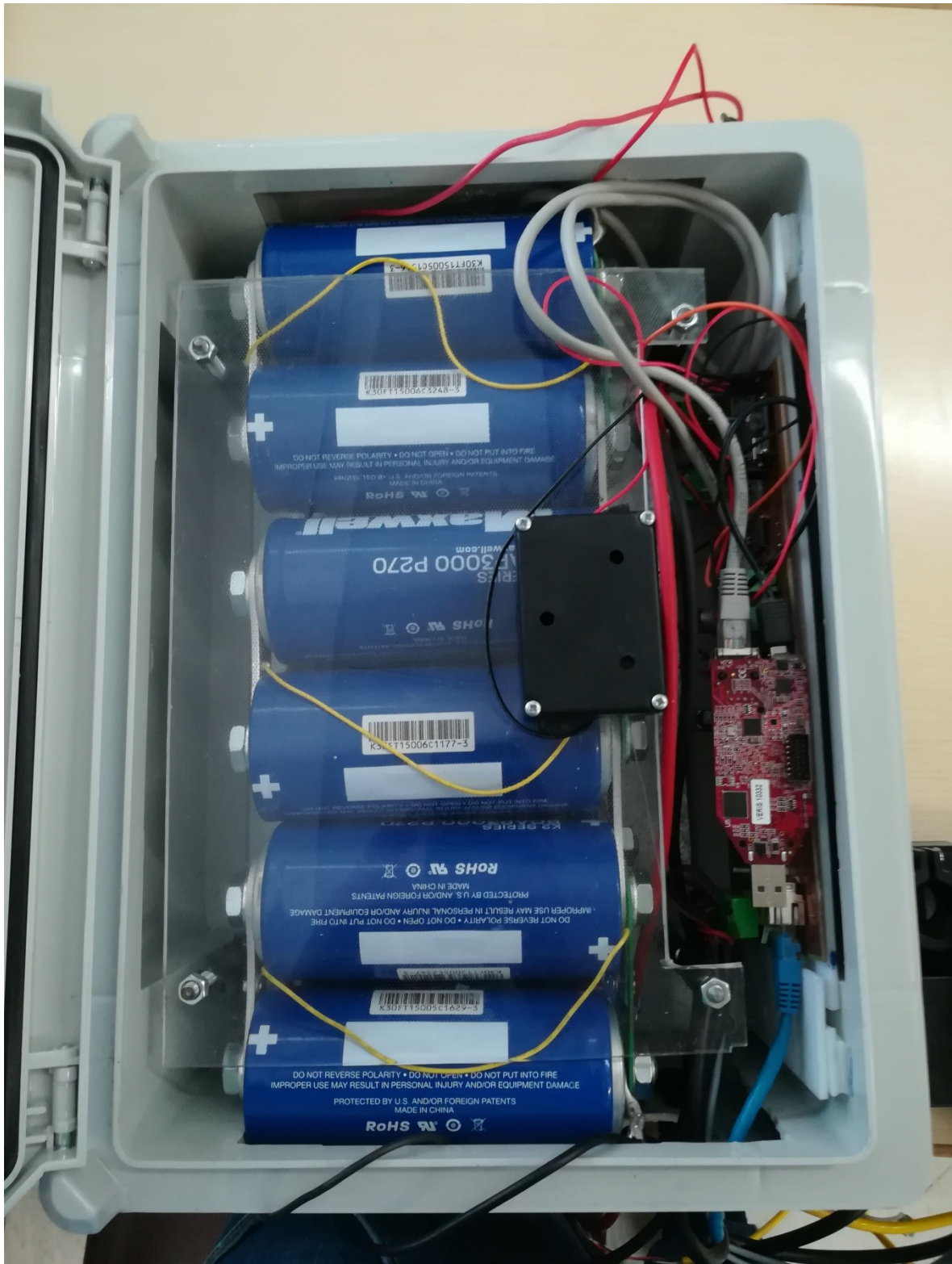
Εικόνα 43: Σύστημα δειγματοληψίας – μέτρησης – αποθήκευσης – μετάδοσης πληροφορίας τοποθετημένο σε κουτί
