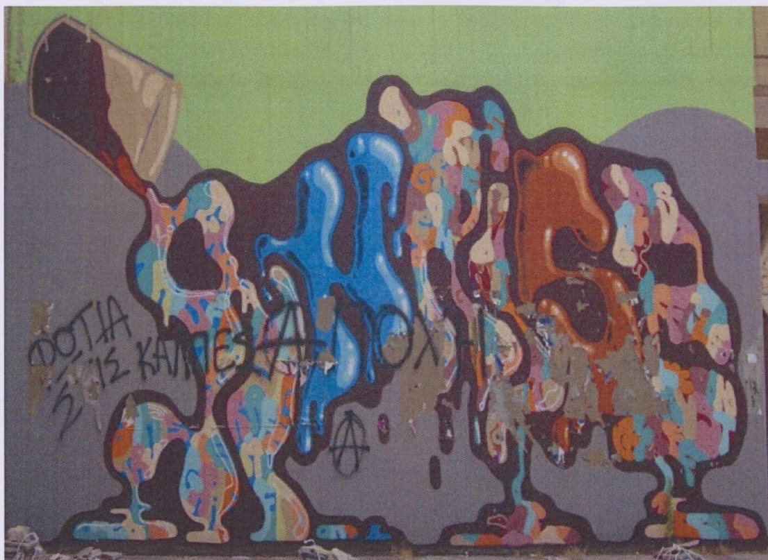
Παιδαγωγικό Τμήμα Δημοτικής Εκπαίδευσης, Εξωτερικά. Γκραφίτο σε φθαρμένο τοίχο που ξεφλουδίζει ο σοβάς. Φωτ. 135.
