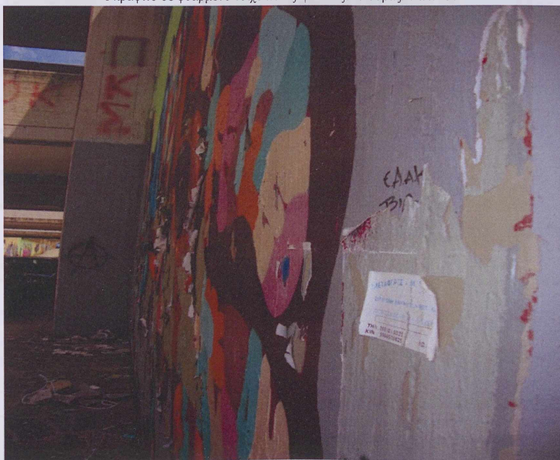
Παιδαγωγικό Τμήμα Δημοτικής Εκπαίδευσης, Εξωτερικά. Γκραφίτο σε τοίχο που ξεφλουδίζει ο σοβάς. Λεπτομέρεια από πλάγια όψη. Φωτ. 141.
