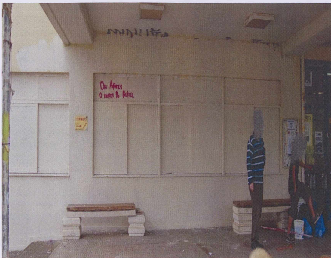
Φοιτητικές Κατοικίες Α' - ΘΕΣΠΙ, Εξωτερικά. Δημιουργία γκραφίτι, 15-17/5/2010. Η σημείωση γράφει: Όχι αφίσες. Ο χώρος θα βαφτεί. Φωτ. 057.
