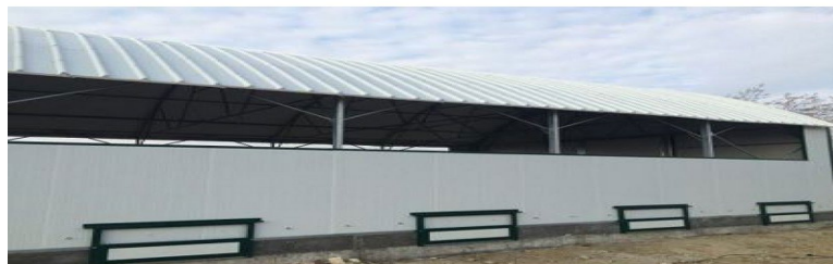
Σχήμα 6. Η εξωτερική μόνωση πτηνοτροφείου
