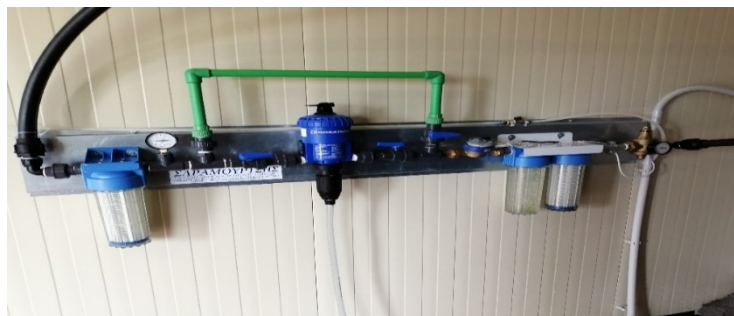
Σχήμα 9. Σύστημα δροσισμού πτηνοτροφείου
