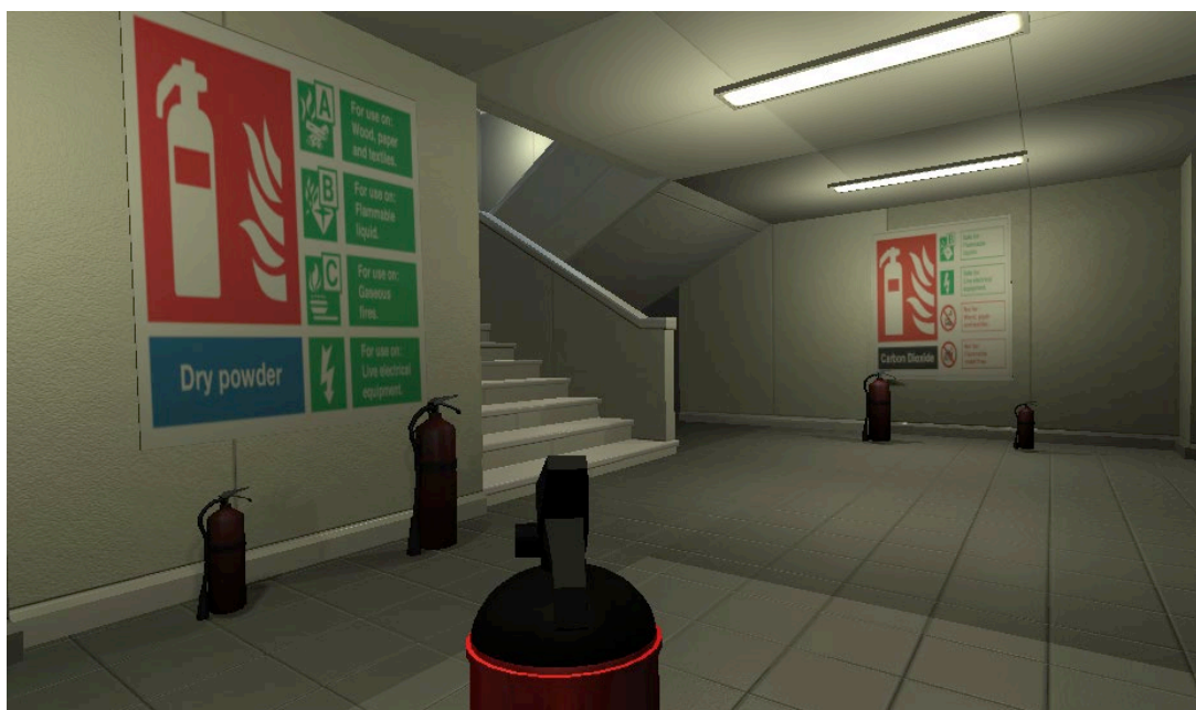
Εικόνα 5-5: Πυροσβεστήρες τοποθετημένοι στον διάδρομο — επιγραφές
