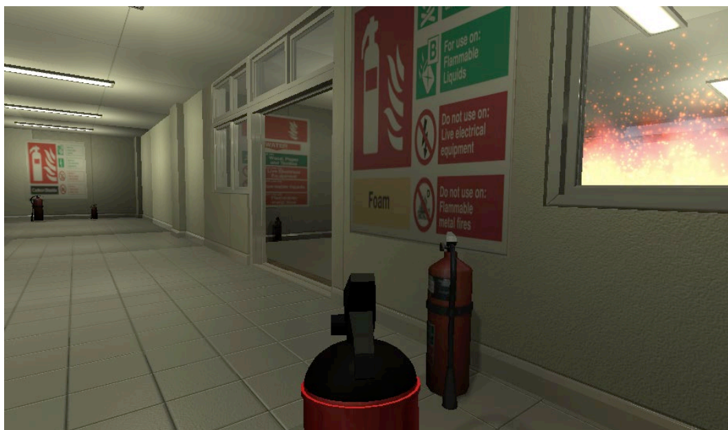
Εικόνα 5-6: Πυροσβεστήρες τοποθετημένοι στον διάδρομο
