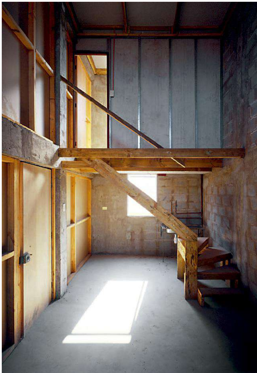
Εικόνα 6 : Μη φέροντες τοίχοι, εμφανής σκελετός γυψοσανίδας, κλειδαριά αυλόπορτας
