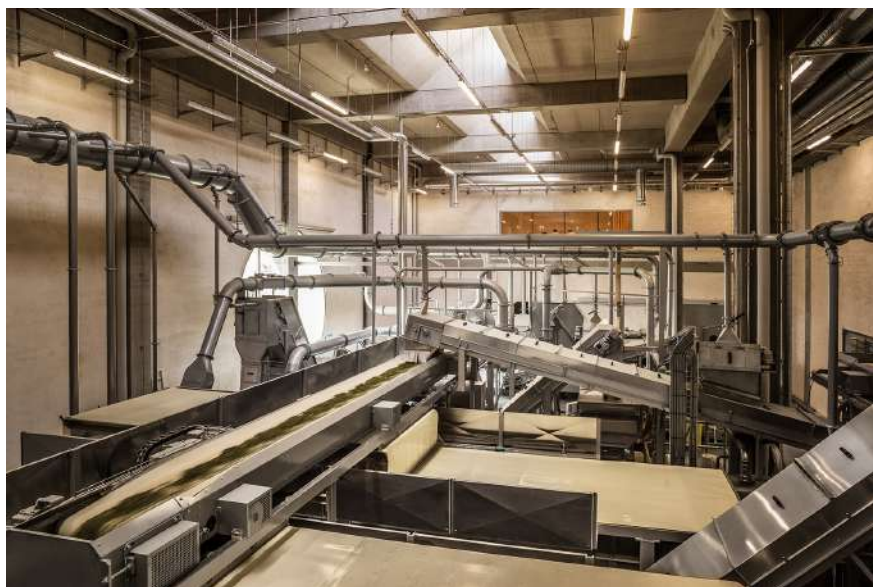
Εικόνα 44 : Εμφανείς αγωγοί και μηχανήματα
