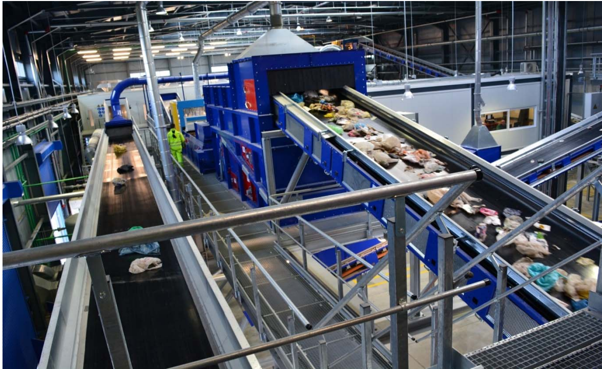
Φωτο 2: Εγκατάσταση σε λειτουργία
