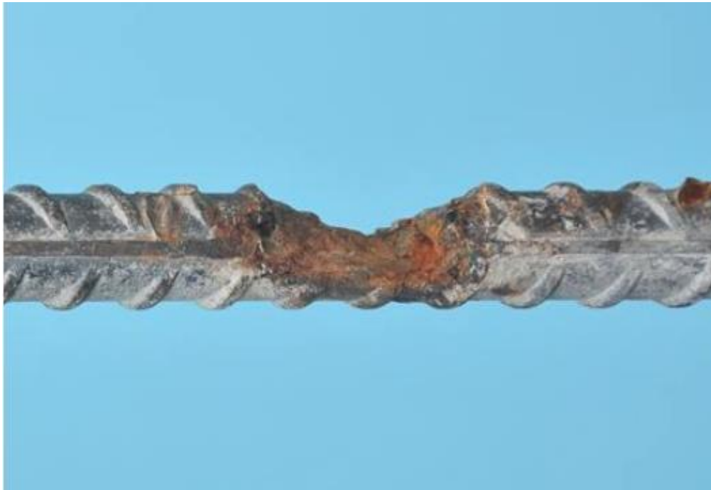
Σχήμα 2.8 Βελονοειδής διάβρωση σε χαλύβδινη ράβδο οπλισμού που προκλήθηκε λόγω προσβολής χλωριόντων στο σκυρόδεμα [12]
