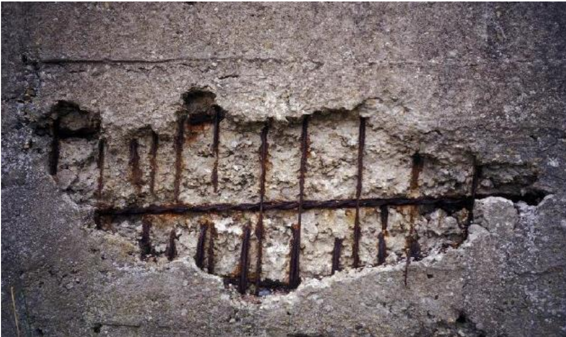
Σχήμα 2.12 Αποφλοΐωση σκυροδέματος λόγω διάβρωσης οπλισμού [17]
