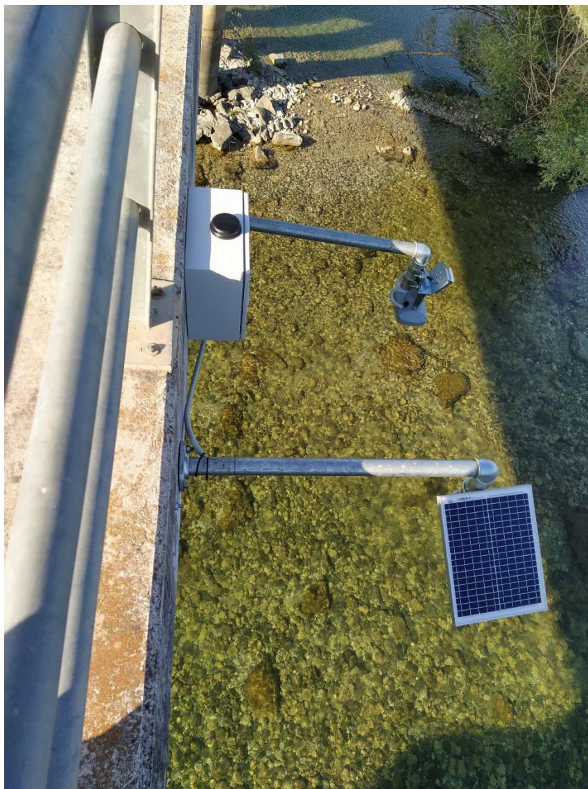
Εικόνα 4-9 Σταθμηγράφος της νέας Γέφυρα Βλαχέρνας
