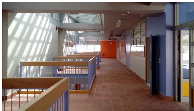
Εικόνα 33: Κενά δαπέδου στην οροφή του ισόγειου διαδρόμου, από την οπτική του πρώτου ορόφου.
