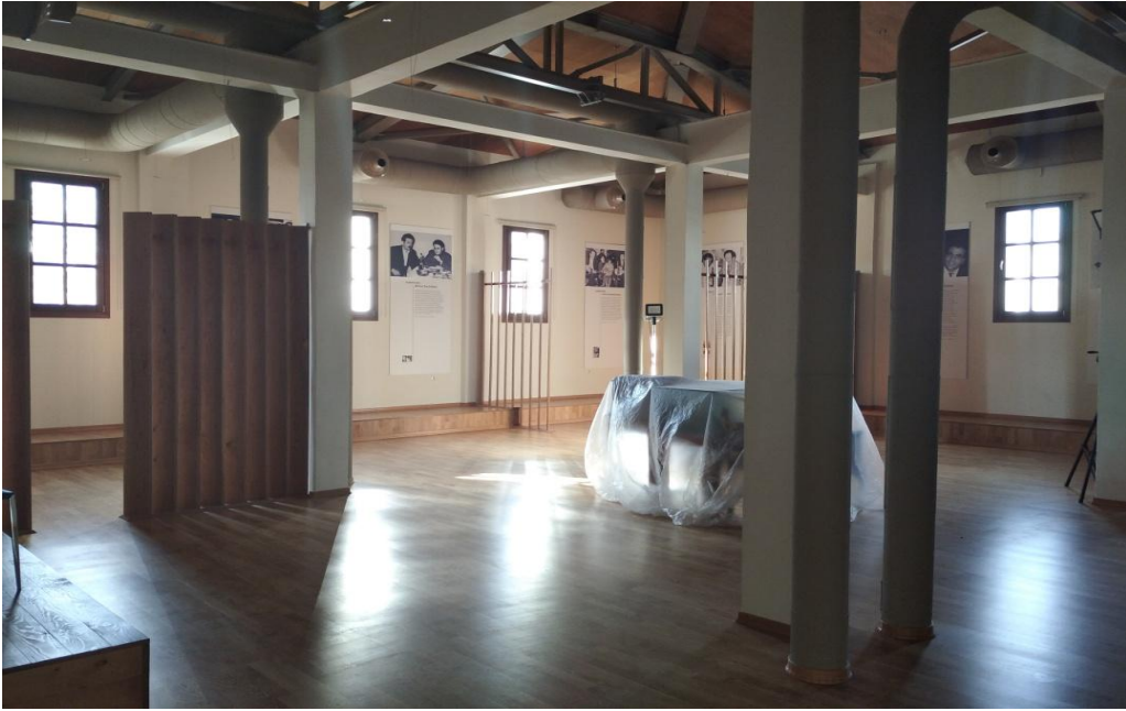
Εικ. 171. Η δεύτερη αίθουσα κατά τη διάρκεια των εργασιών πριν την ολοκλήρωση (Αρχείο Δήμητρα Μπαντή)
