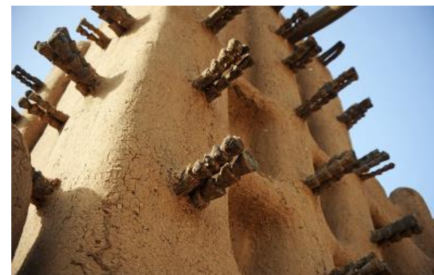
Εικ.119: Ξύλινες ενισχύσεις της φέρουσας τοιχοποιίας και αναμονές για την επισκευή και συντήρηση της
