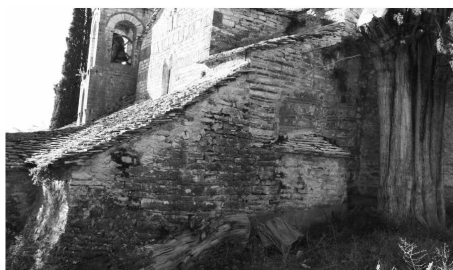
Εικ. 12. Άνω Λάμποβο, ναός της Κοιμήσεως της Θεοτόκου. Ανατολική πλευρά. Διακονικό (φώτο Π. Δαμούλος).
