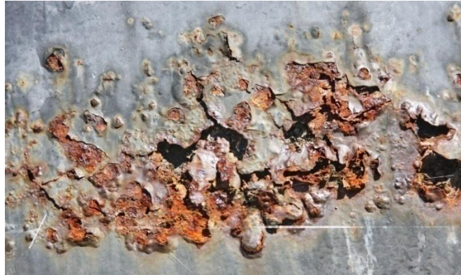
Σχήμα 1.1.3 Αλλοιωμένη μεταλλική επιφάνεια λόγω σκουριάς.
