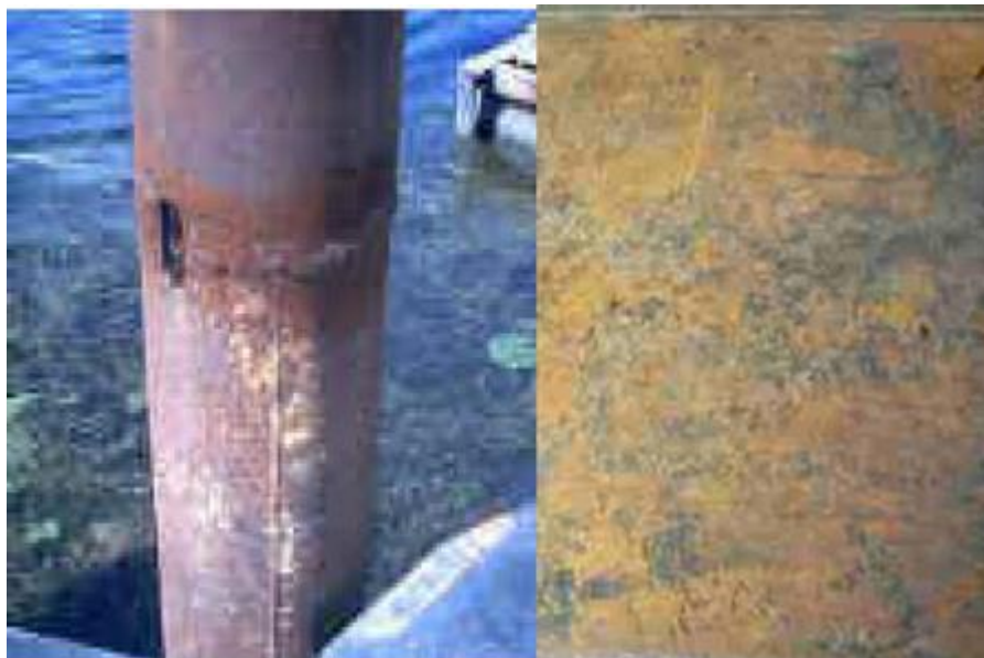
Εικόνα 1.8: Γενική ή ομοιόμορφη διάβρωση
