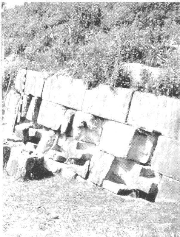
Fig. 2. Vue du mur de soutènement du mémorial Octavien. Photo W. Murray.
