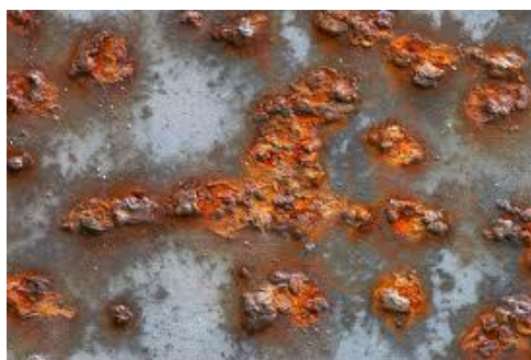
Εικόνα 6: Διάβρωση μεταλλικού τμήματος δεξαμενής. 21
